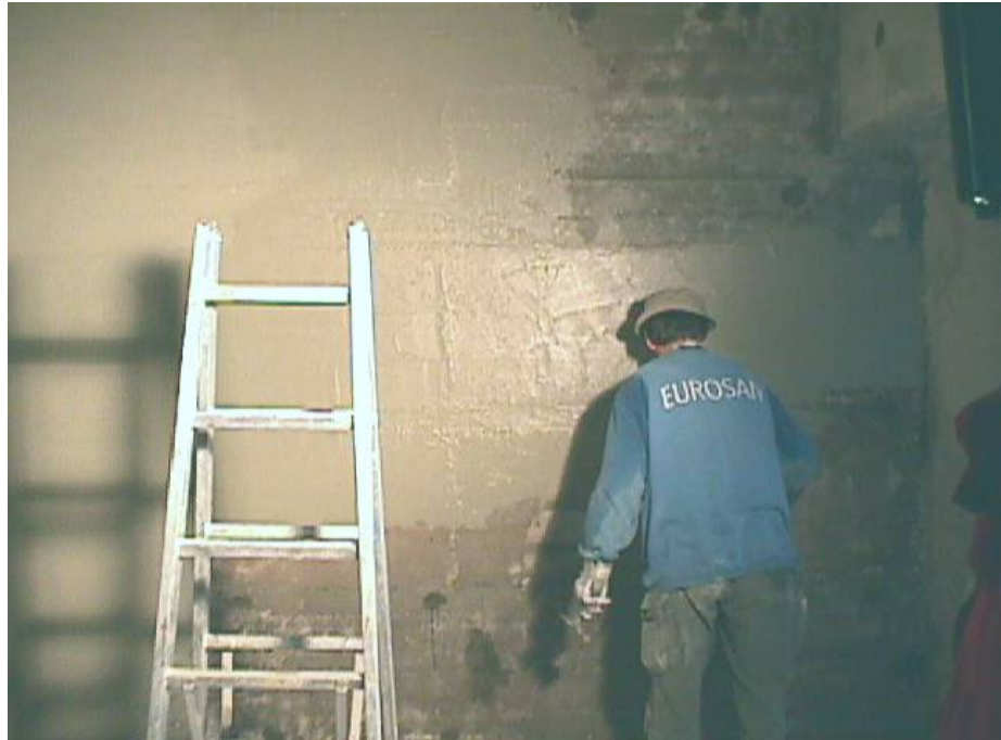
Sanierungs- und Abdichtungsarbeiten an großflächig nassen, mit Salzen belasteten Betonwänden einer Tiefgarage mit Cembond M 945.
